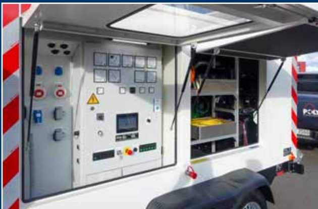
Wie bei allen POLYMA Tandemaggregaten ist der Schaltschrank bedienungssicher im Verkehrsschatten in Fahrtrichtung rechts angeordnet.
