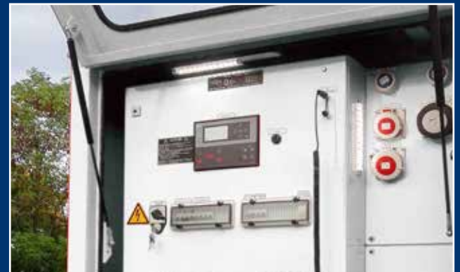
Übersichtliche Schaltanlage im Verkehrsschatten angeordnet.
